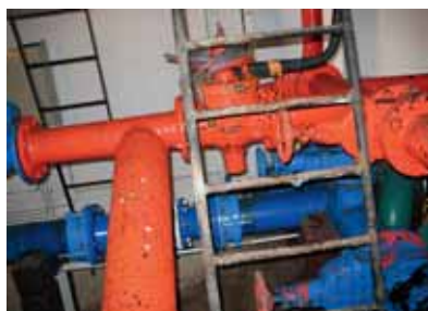
Canalisations dans un réservoir.
