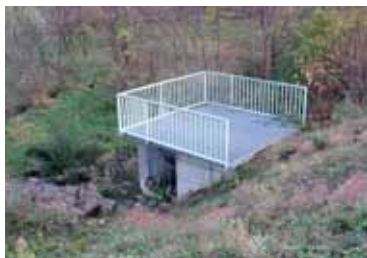
Dans le grand bassin d'orage, l'ouvrage d'arrivée des eaux pluviales collectées par le réseau séparatif.
